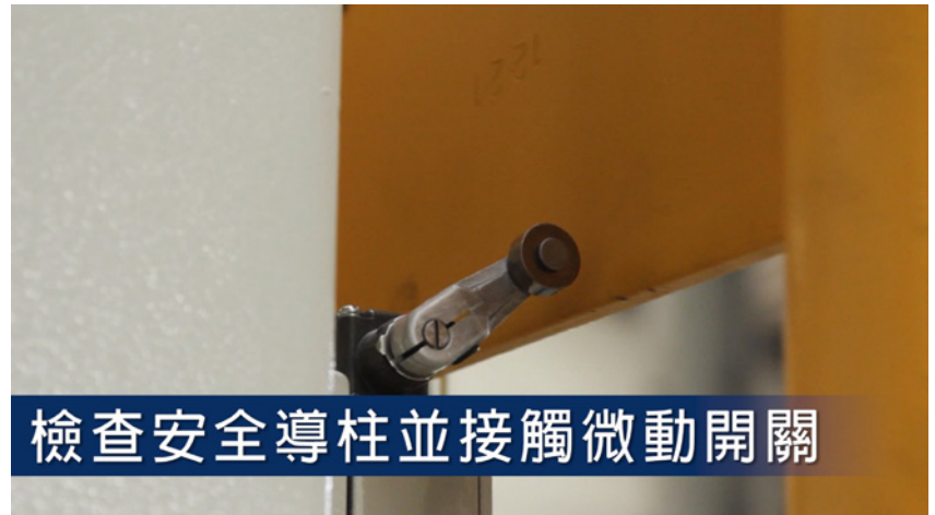
檢查安全導柱並接觸微動開關
