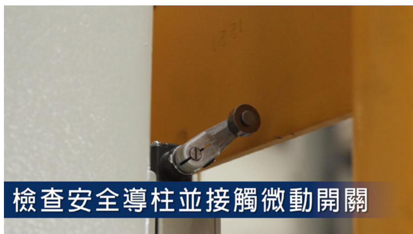
檢查安全導柱並接觸微動開關
